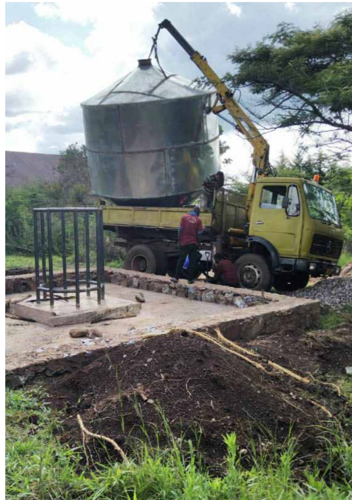
Die Versorgung mit sauberem Trinkwasser ist eines der Projekte von MAVUNO.
