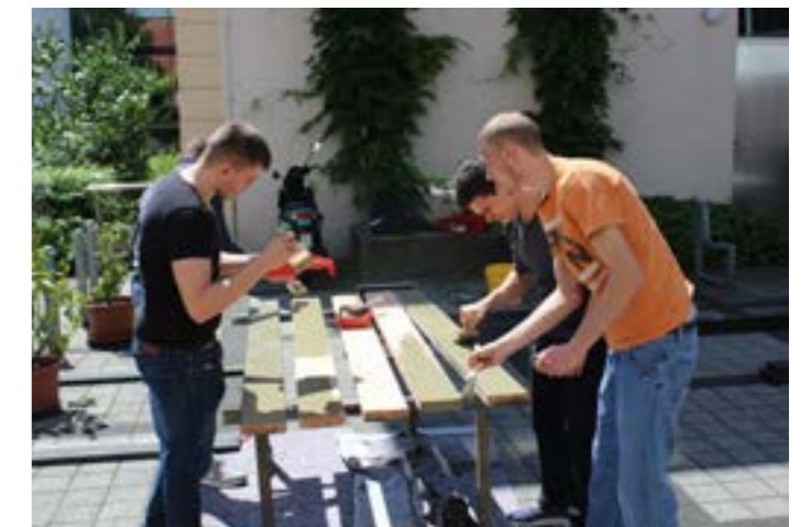
Zwölf Parkbänke des St. Nikolai erstrahlen nach der Renovierung durch unsere Azubis in neuem Glanz.
